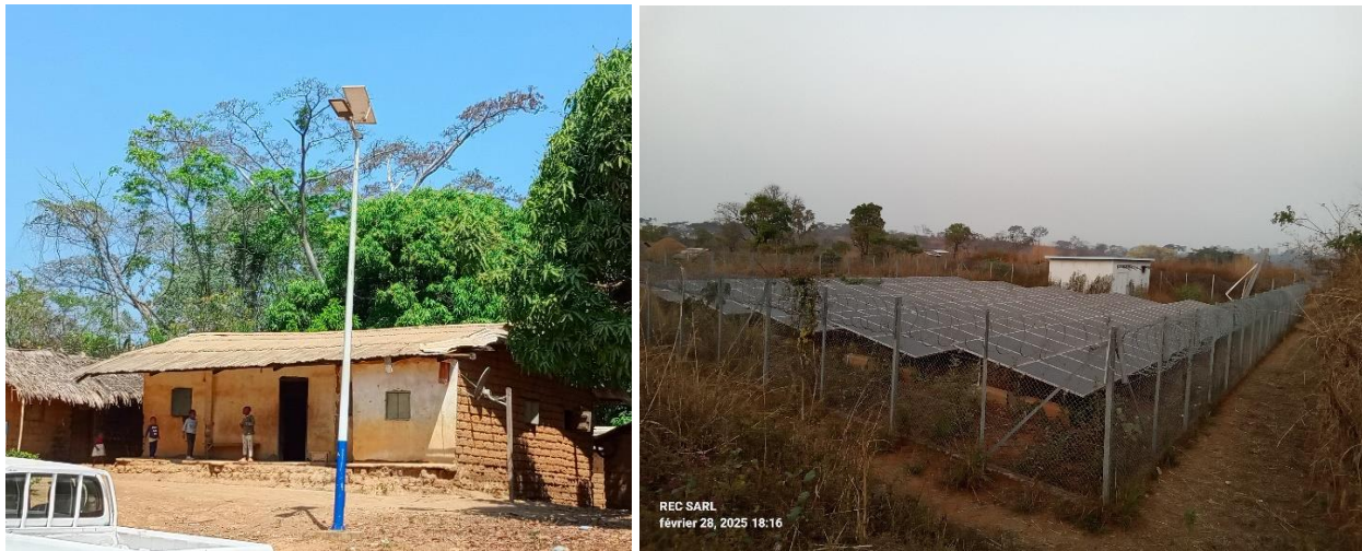
Photo 9: Eclairage par lampe solaire à Kong et champ solaire dans le village Léna
